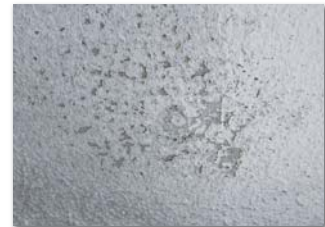
塗膜の剥がれ
